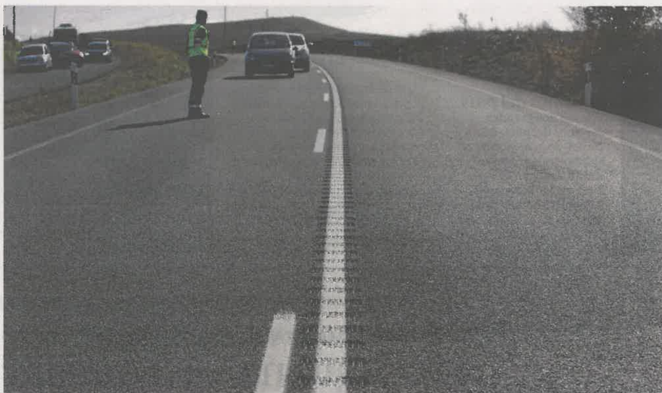
Las nuevas bandas en el kilómetro 11 de la carretera A-375, que une Utrera (Sevilla) y Puerto Serrano (Cádiz) V. GÓMEZ
