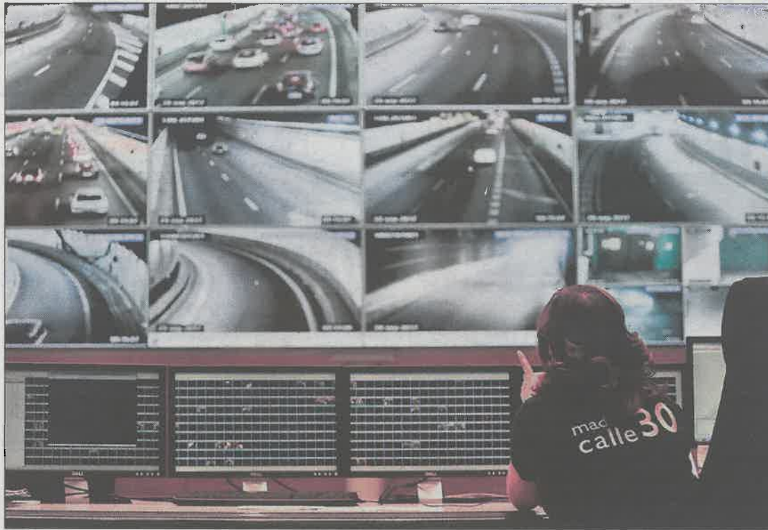
Una operaria supervisa ayer el tráfico en el centro de pantallas de la M-30. / KIKE PARA
