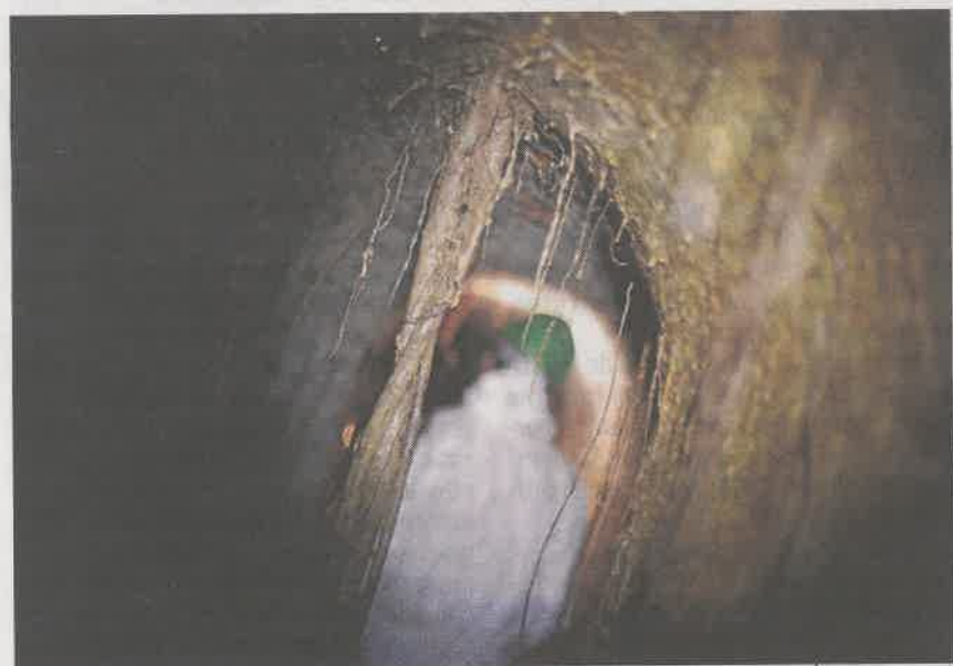
Las raíces y la humedad recubren las paredes de las galerías
