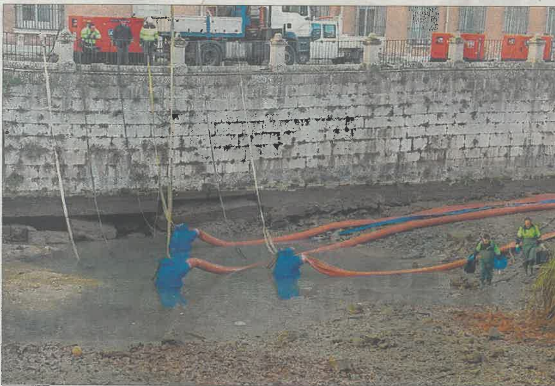
Los trabajos de vaciado de la ría permitieron apreciar el descalce del muro del palacio. / PATRIMONIO NACIONAL
