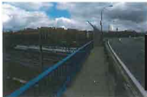
Sistema actual de protección peatonal en el viaducto
